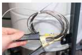
Liaison équipotentielle et mise à la terre
